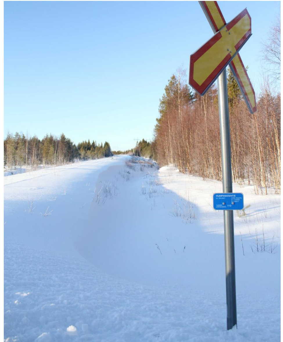
Otanmäen rata. Rata kulkee matalalla penkereellä. Rata ei ole nykyisellään käytössä, kiskot ovat hautautuneet lumen alle.
